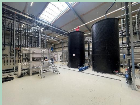
Messfeld (elektrische Leitfähigkeiten), Betriebshilfsstoffbehälter
