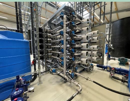
Membraneinheit der 3-stufigen Umkehrosmose (3. Prozessschritt)
