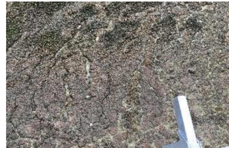
rissige Schwimmschicht, Blasenbildung
