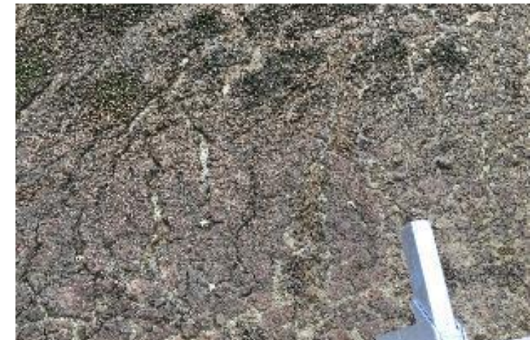
rissige Schwimmschicht, Blasenbildung
