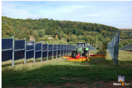
Agri-PV Park Dirmingen (Saarland) mit 2 MWp
